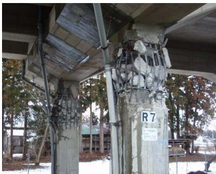
(b) 損傷度B1の被害(第一中曽根高架橋の端部柱)
