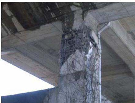
(c) 損傷度B2の被害
