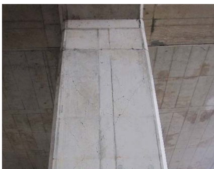
(d) 損傷度Cの被害
