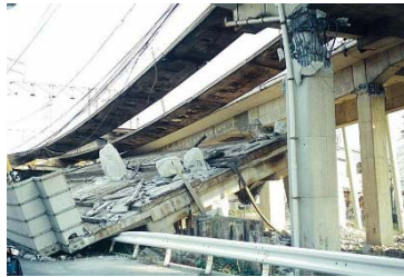
※写真は兵庫県南部地震の被害
