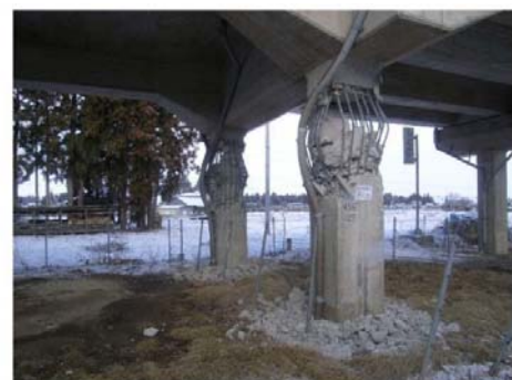
写真-2 第一中曽根高架橋の損傷状況(起点側) 9)
